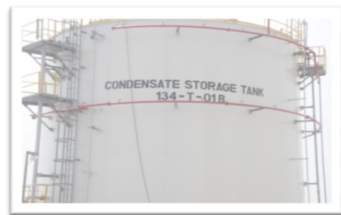
Condensate Storage Tank Ujung Pangkah - Hamerada Hess 2006
