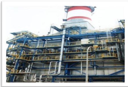
Structure HRSG PLTGU PT. Indonesia Power UBP Semarang 2004 - 2008
