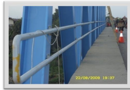
Jembatan Citarum I PU Bina Marga - 2008 Epoxy (75 micron) - Acrylic (50 micron) Simacover EP Unicoat - Simacare Finish
