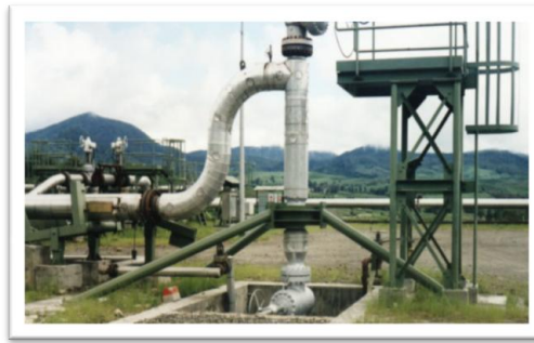
Wellhead Accesoris PT. Magma Nusantara 2004 - 2006
